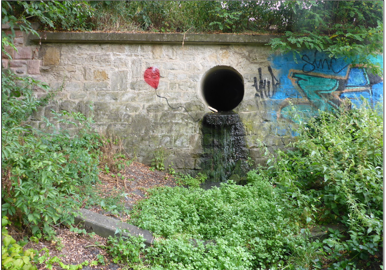
Abb. 8: Kontinuierliche Einleitung unmittelbar flussab der Brücke der A73 auf Fürther Seite in die Pegnitz im August 2019
