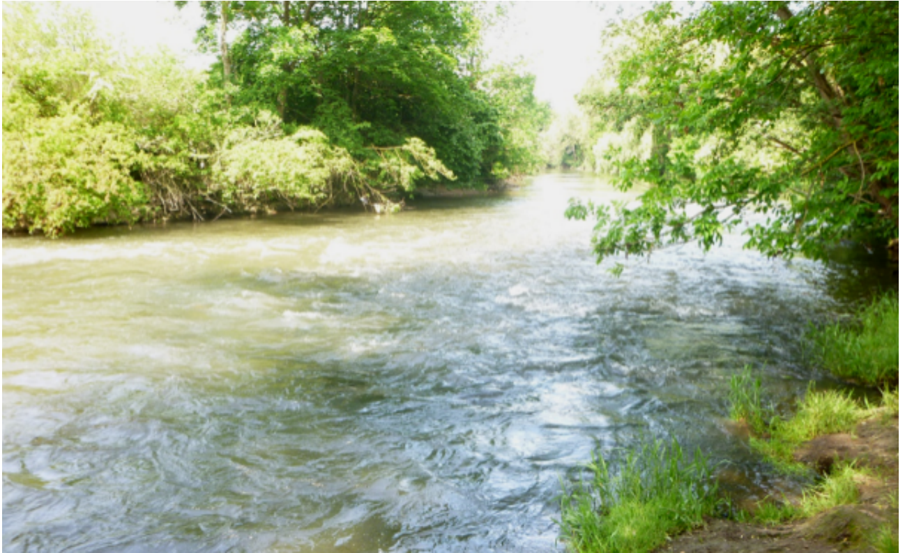
Abb. 32: Sohlgleite bei PS 2_F ist nur bedingt durchwanderbar. Bei erhöhten Wasserständen wird die Sohlgleite hydraulisch überlastet. Empfehlung: Umbau der Sohlgleite in Pendelrampe, Anlegen eines Kieslaichplatzes im Unterwasser der Pendelrampe und Entfernung der Uferverbauung. Strukturverbessernde Maßnahmen in Form von Störsteinen, Totholzbühnen und allgemein Totholz zur Strömunglenkung. (Foto: R. Bäumlner).
